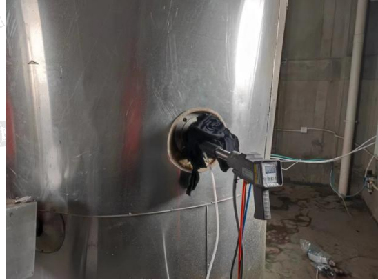
◎有组织废气采样点 - 2#焚烧炉
