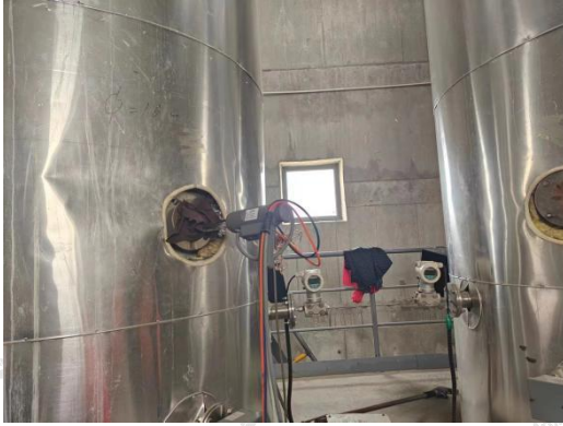
◎有组织废气采样点 - 1#焚烧炉
